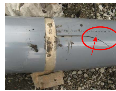
隙間部破壊 上部
