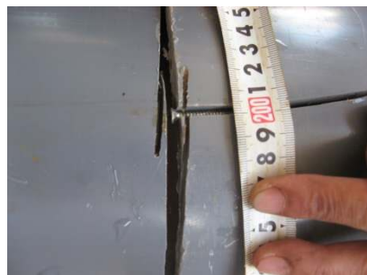
軸方向クラック 管ずれ状況
