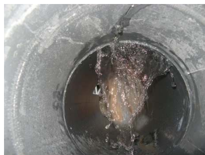
軸方向クラック・ 浸入水管内状況
